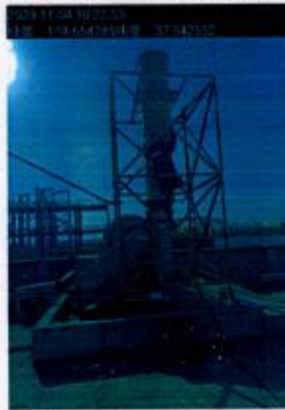
DA010三车间2#排气筒
