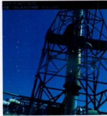
DA006一车间噻啉尾气吸收排气筒
